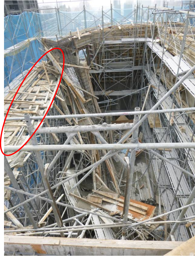
說明：意外發生現場照片。（紅色圓圈處為原屋頂造型樑組立位置，其右側為倒塌後之鋼管施工架與模板）
