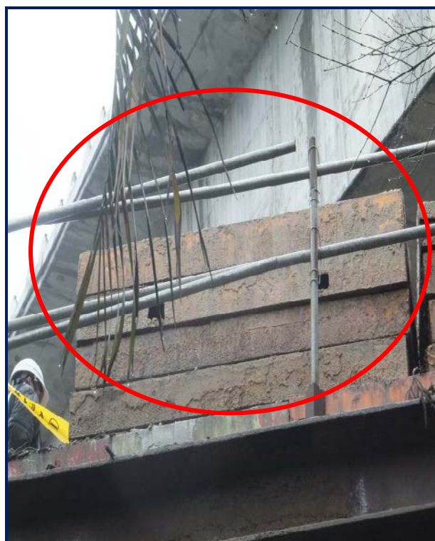
說明：災害發生現場。（圓圈處施工構臺護欄前方堆放物料，且其高度及杆柱錨錠強度不足）
