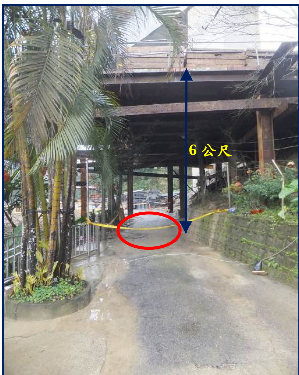
說明：災害發生現場。（圓圈處為張員墜落地點，墜落高度約 6 公尺）
