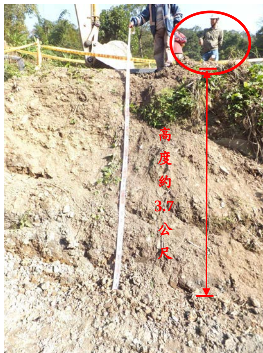
說明：圓圈處為受傷者墜落起點位置。 （墜落高度約 3.7 公尺，）
