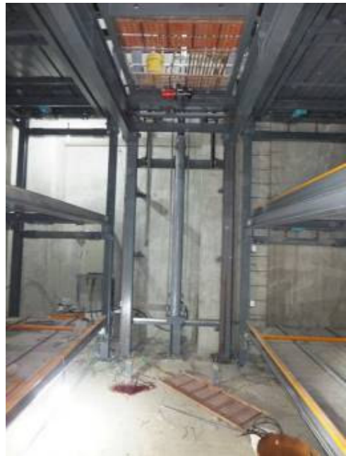
圖二 地面長條形格柵物即為疑似跌落之踏板
