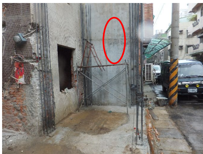
圖一、災害現場鋼筋組立作業所使用之施工架（紅圈為勞工站立位置）。
