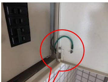
配電盤妥善接地
