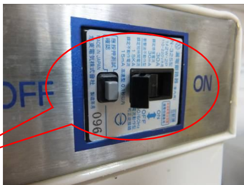
茶水間蒸飯箱 漏電斷路器
