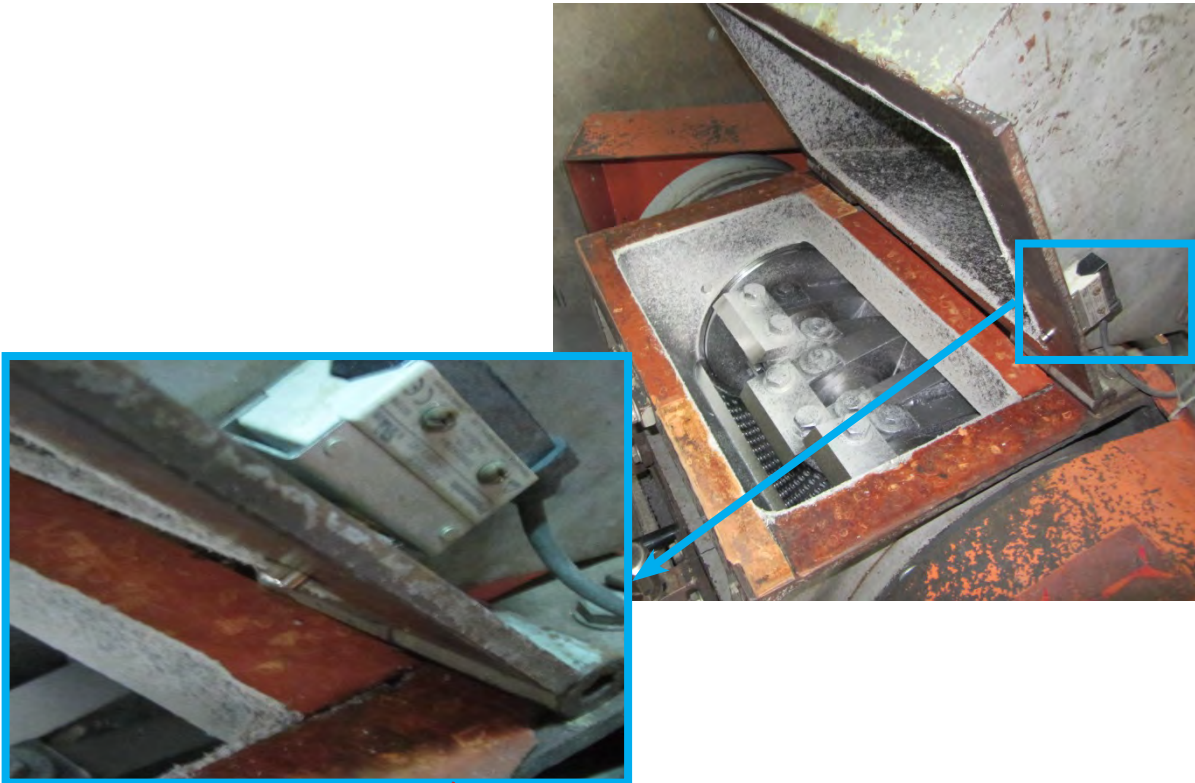
連鎖裝置 ระบบอินเตอร์ล๊อค
