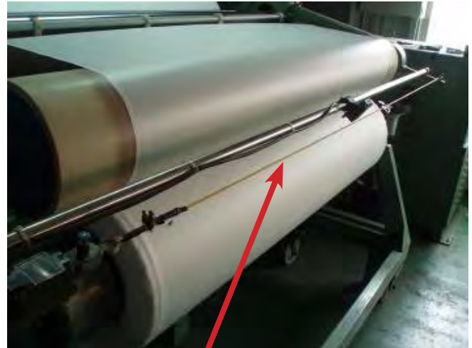
ติดตั้งสายดึงฉุกเฉิน 緊急制動裝置
