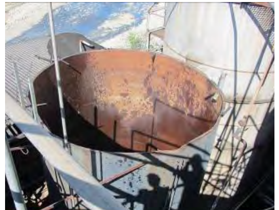
ภาพทั้งหมดของช่องระบายกลีเซอริน 甘油槽全貌
