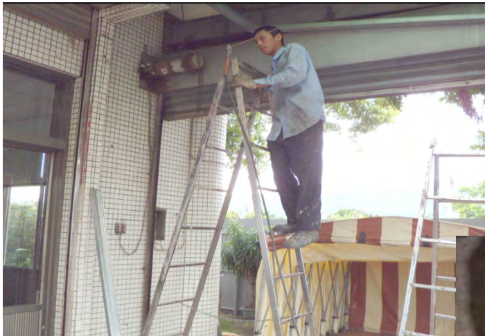
ผู้เสียชีวิตยืนทำอาชเชื่อมบนชั้นบันไดสูงประมาณ 165 เซนติเมตร ในรูปเป็นภาพจำลองเหตุการณ์ 罹災者站立於高約 165 公分合梯踏階從事電焊作業。(模擬照片)
