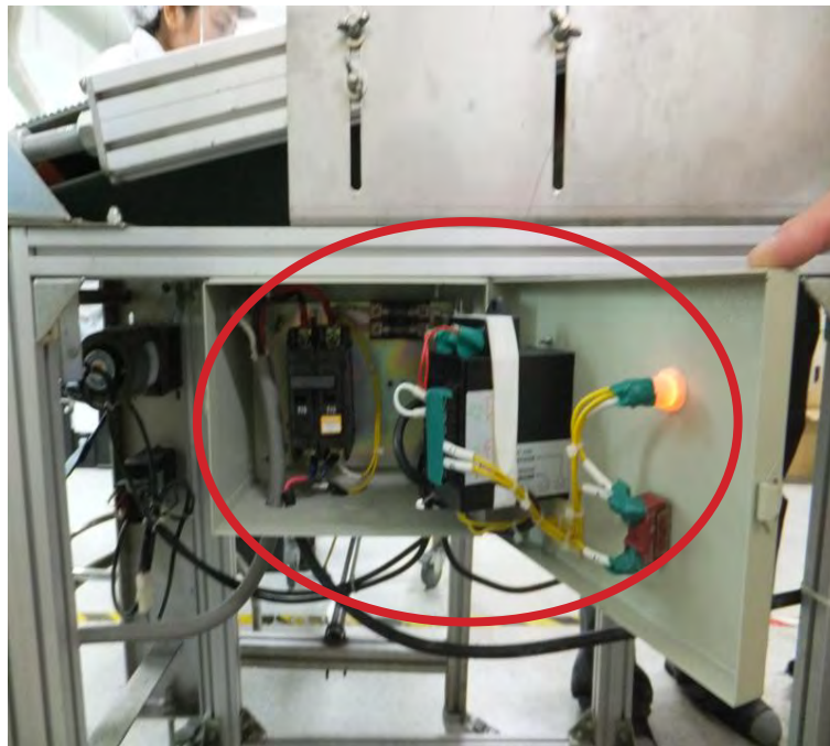
หลังเกิดเหตุทางบริษัทได้ใช้สายเทปเขียวพันตรงจุดเชื่อมต่อสายไฟไว้แล้ว 事發後該公司已使用絕緣膠帶包覆接點
