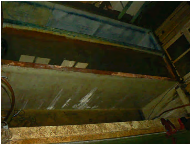
Bồn nơi xảy ra sự cố 事故槽
