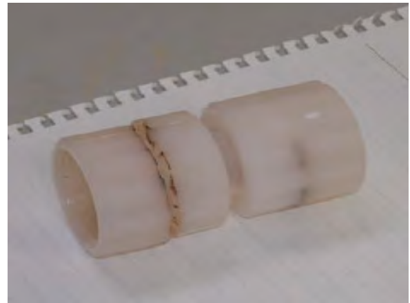
Hình ảnh cục nối ống của hệ thống ống dung dịch TMAH bị nứt vỡ.
