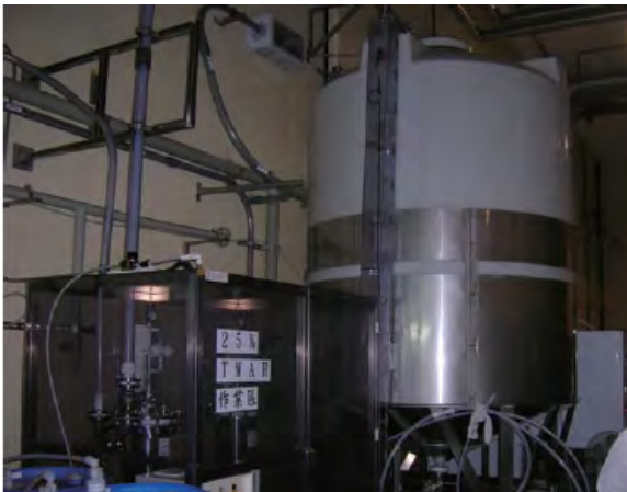
Hình ảnh về hệ thống ống dung dịch TMAH tại hiện trường.
