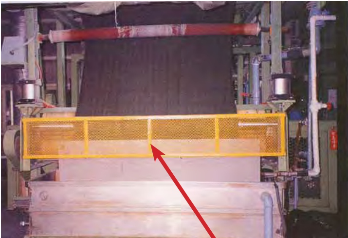
Màn chắn an toàn 護圍
