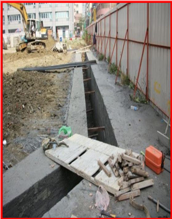
Before 導溝未設置護蓋
