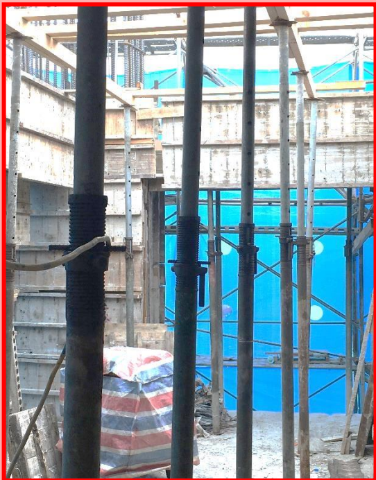
Before 未使用制式金屬配件
