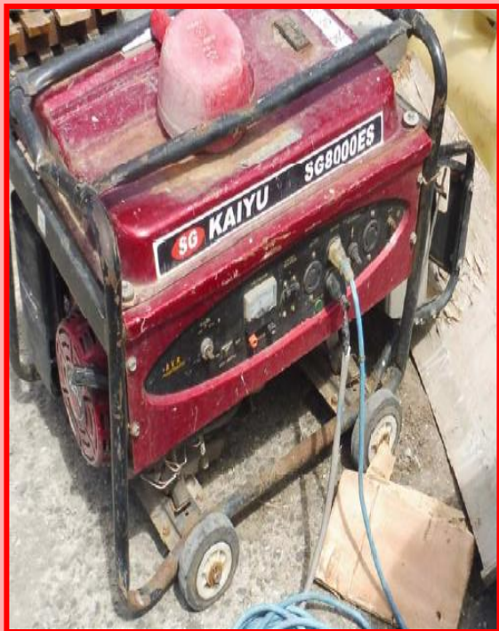
Before 未設置漏電斷路器
