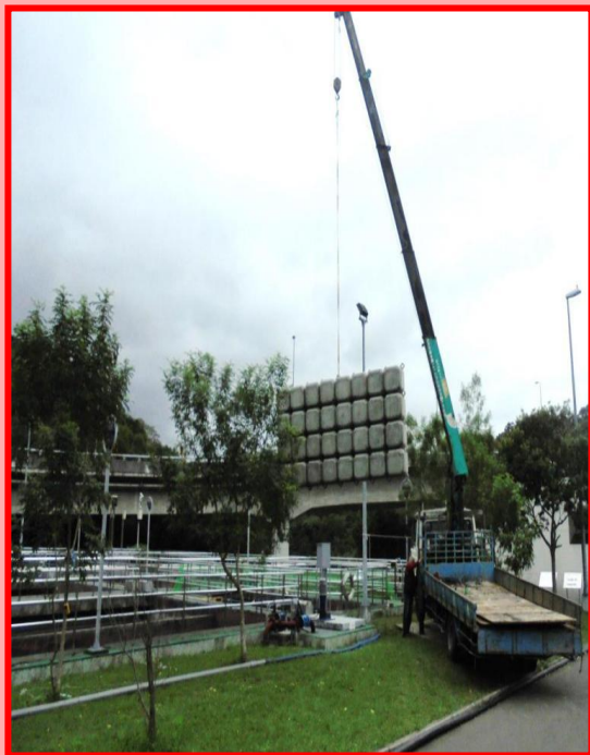
Before 未設防止人員進入措施
