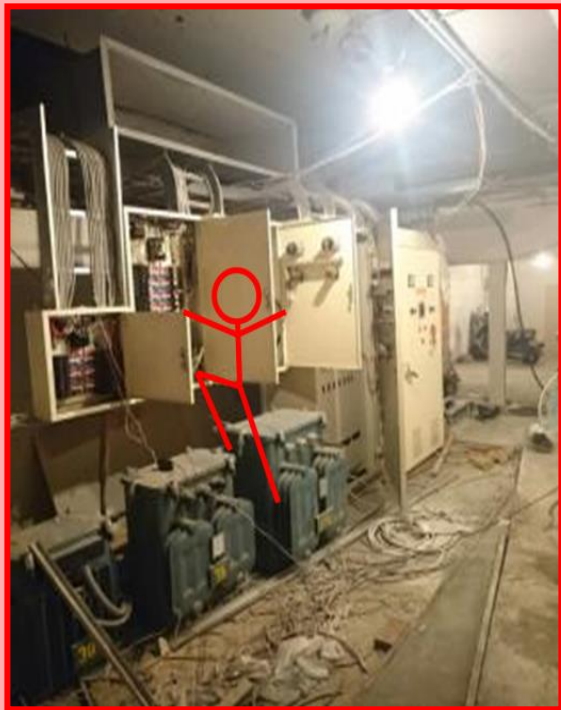
Before 未戴用絕緣防護具
