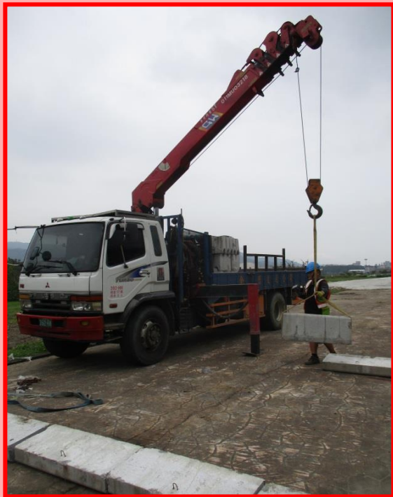
Before 未設防止人員進入措施
