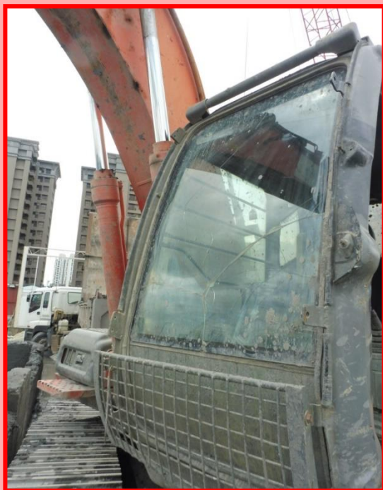
Before 未設置擋風玻璃
