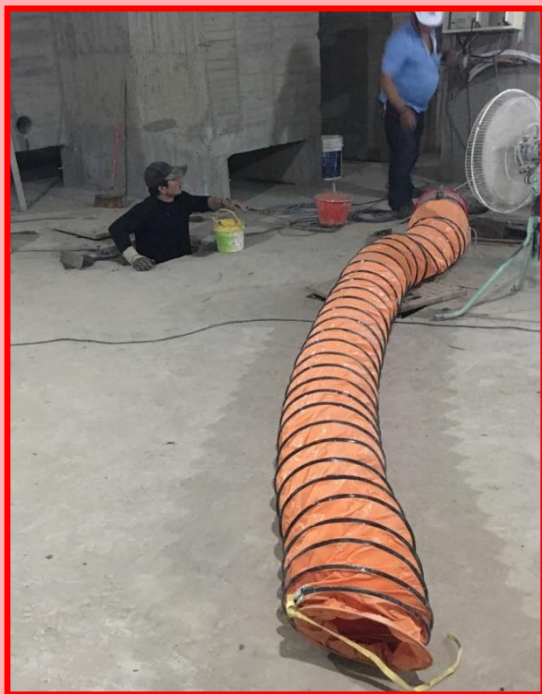
Before 未設置局部排氣裝置
