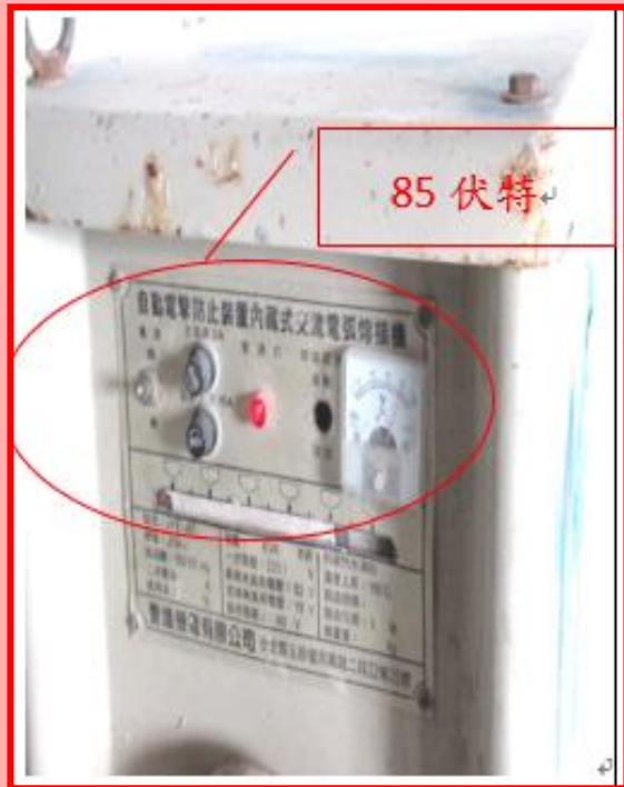
Before 安全電壓超過25伏特
