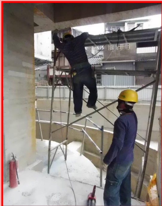
Before 未設置安全上下設備
