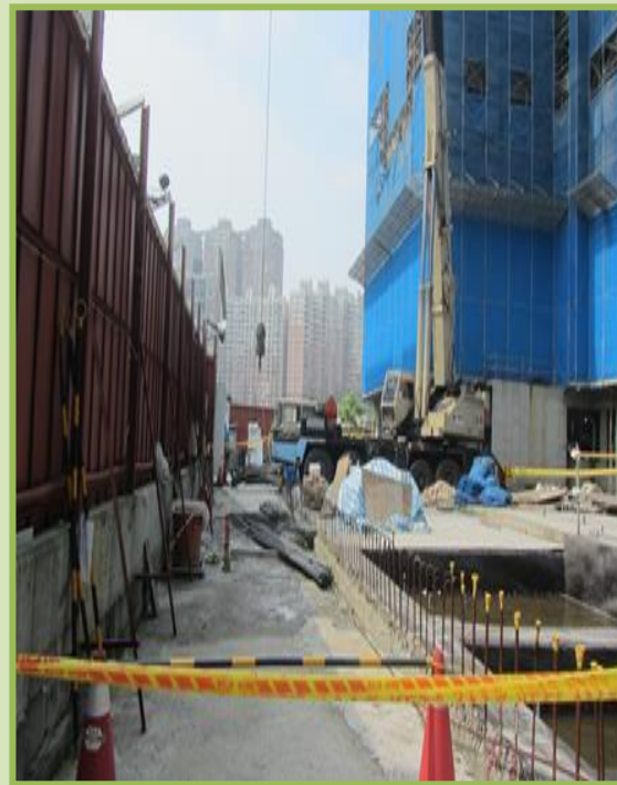
After 已設防止人員進入措施
