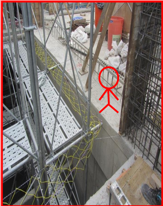
Before 開口未設置防護
