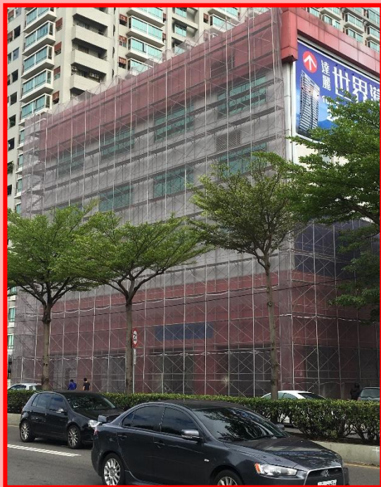
Before 施工架未設置斜籬
