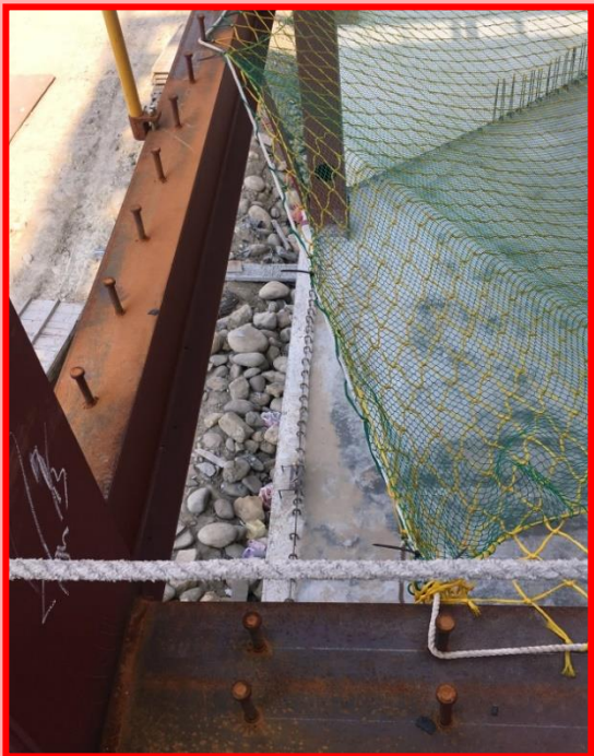
Before 鋼樑吊裝前未鋪滿安全網
