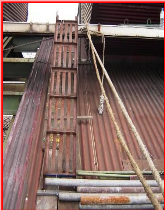
Before 未設適當踏板及防護
