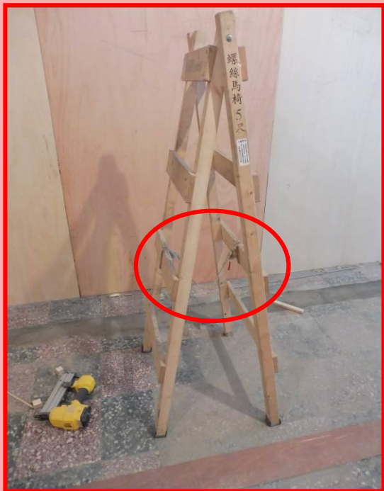
Before 未設置金屬硬質繫材
