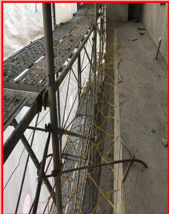
Before 未與構造物妥實連結
