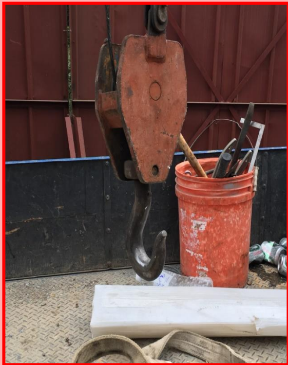
Before 未設置防滑舌片
