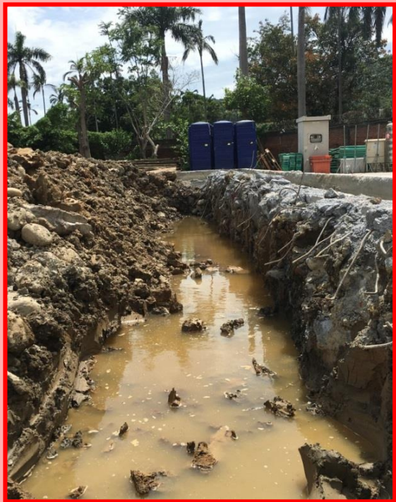
Before 土石積水未清
