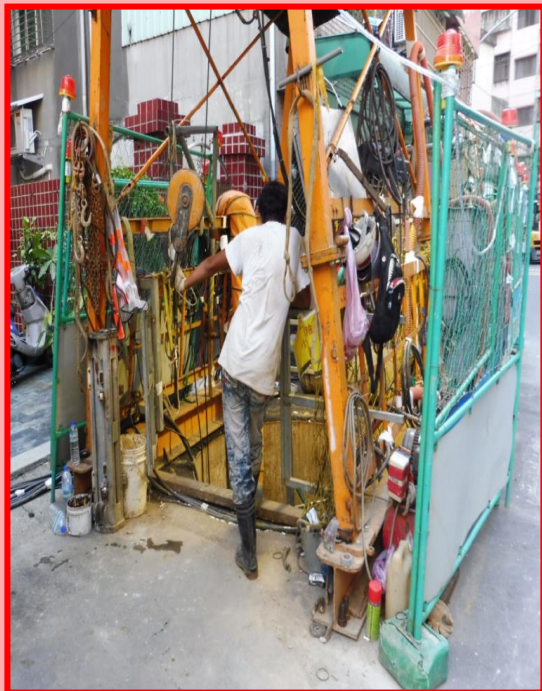
Before 未使勞工採取防墜措施
