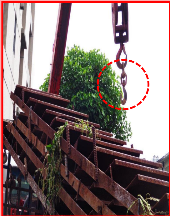
Before 未設置防滑舌片
