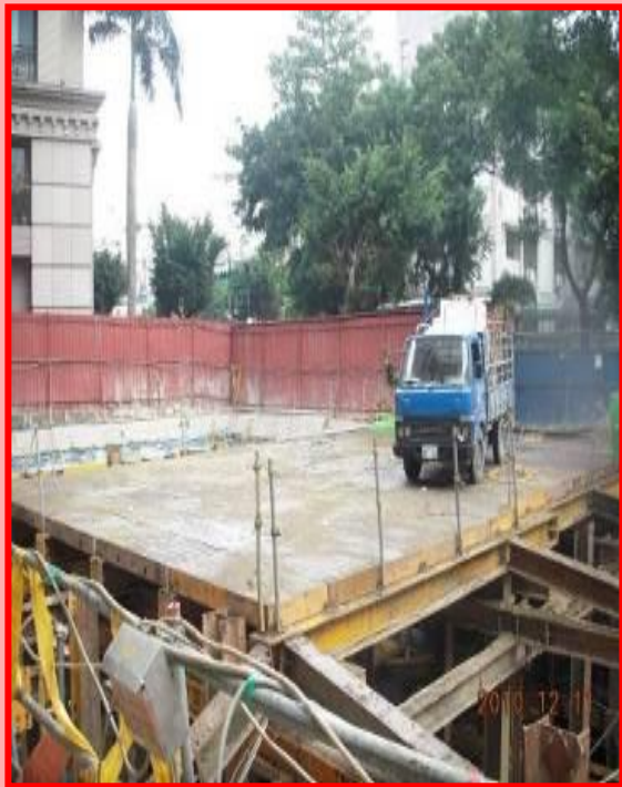
Before 未設置護欄
