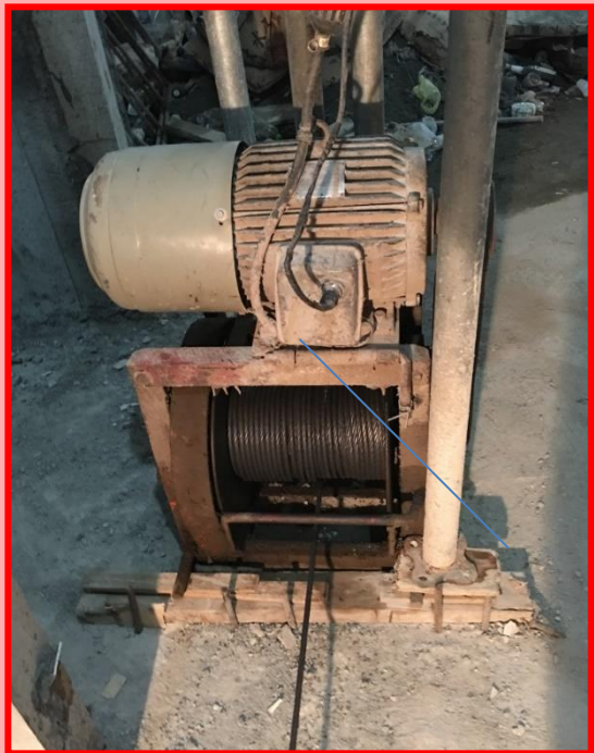
Before 未設置防護設施
