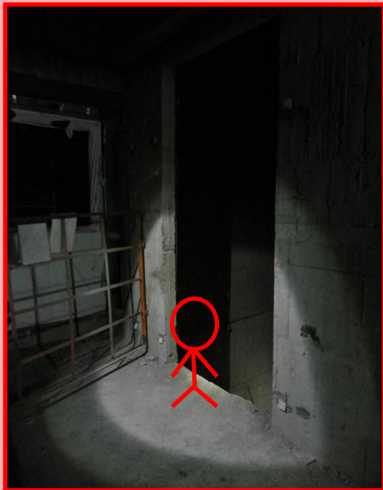
Before 未設置防墜措施
