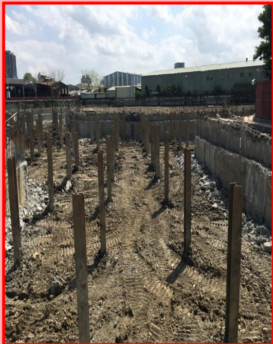
Before 未設置安全上下設備
