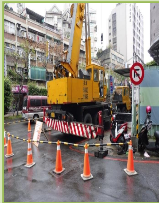
After 已設防止人員進入措施
