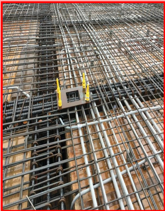
Before 結構表面未鋪以木板
