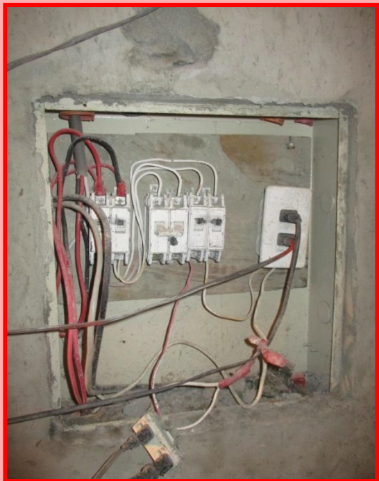
Before 未設置漏電斷路器
