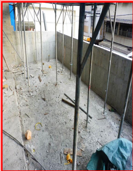
Before 施工架未設置交叉拉桿
