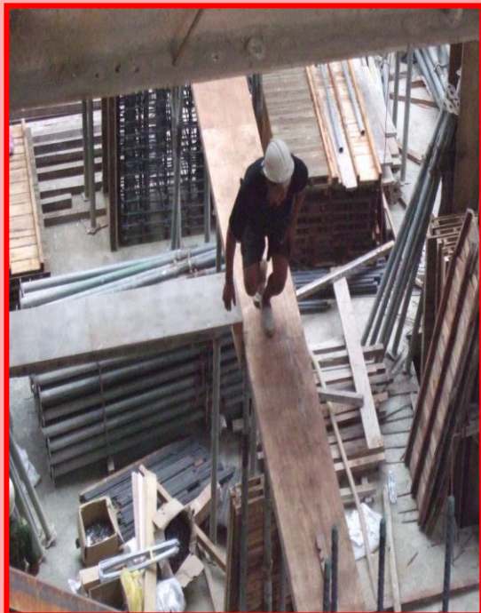
Before 未使用防墜措施
