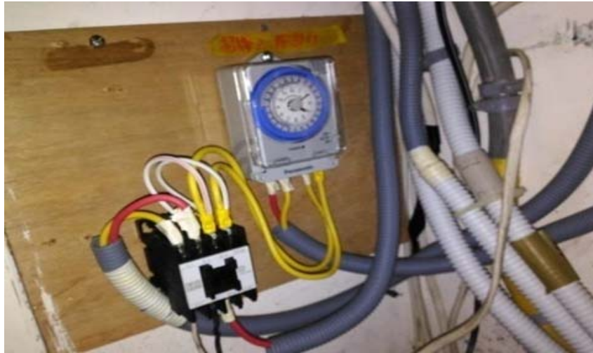
圖 3-4 未關閉廣告專用電源
