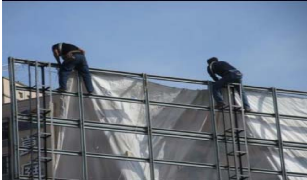
圖 3-3 高處作業未佩戴個人防護具(非職災現場)
