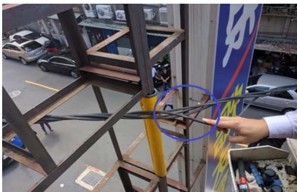
圖 3- 7 電線絕緣表面破損
