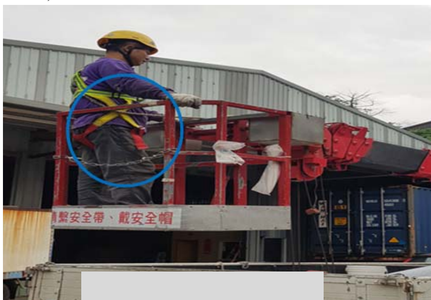
圖 2-15 作業人員不可超出搭乘設備外
