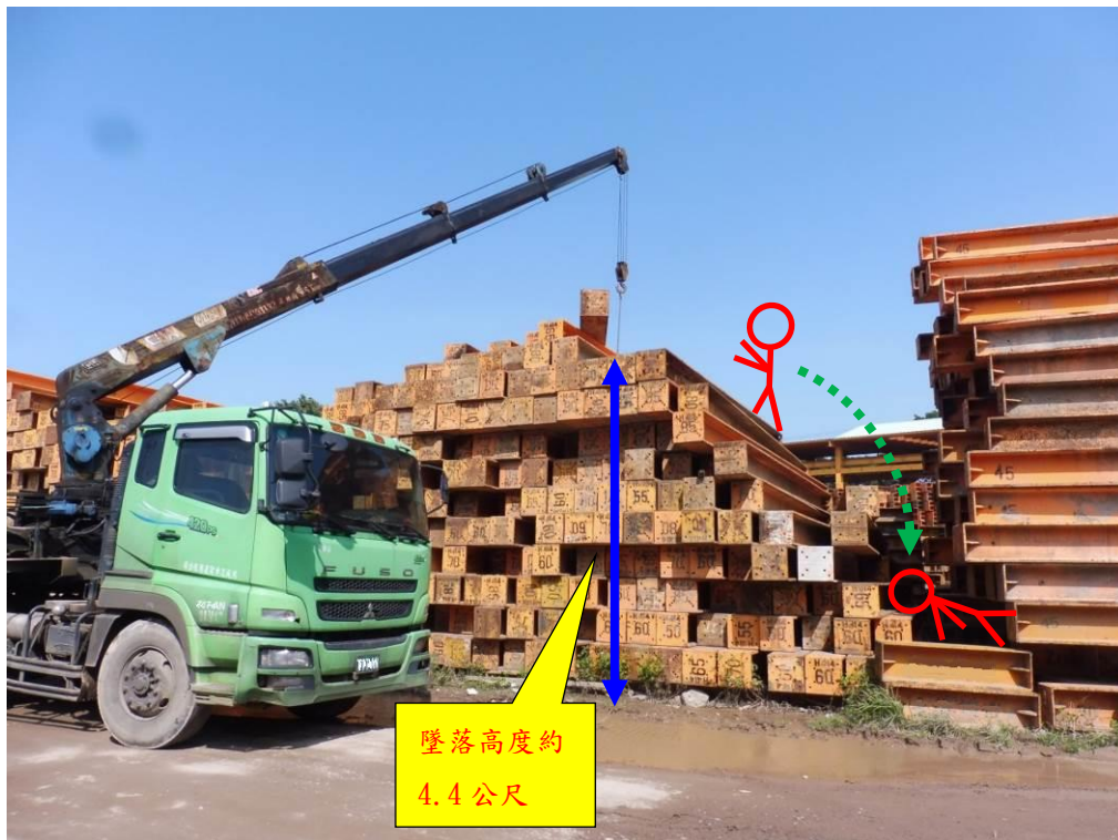
災害現場照片
