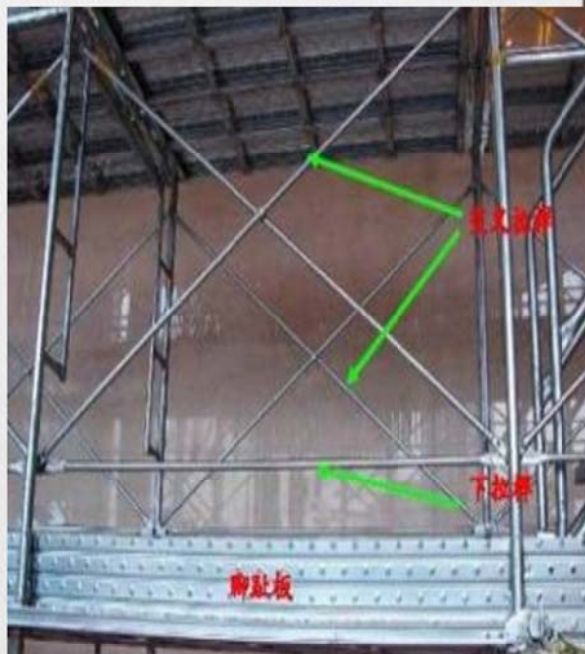
說明：應設置護欄等防護設備
