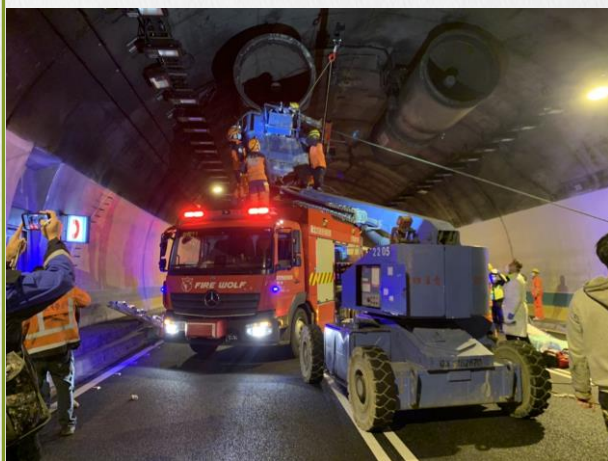
碧潭隧道北上28K+890m (災害現場位置)
