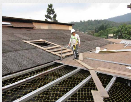
說明：規劃安全通道並設置適當強度踏板，且使勞工戴用安全帽
