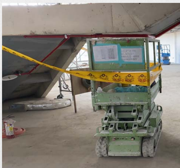
災害發生現場
